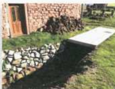
Désableur et enrochement fossé « Kimmerlach »
