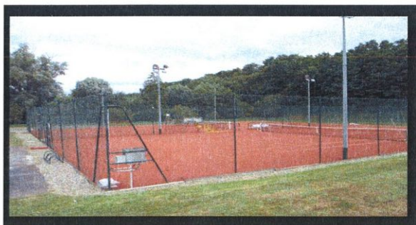
Réfection des 2 courts de tennis en gazon synthétique, pose d'une terre artificielle Claytech©
